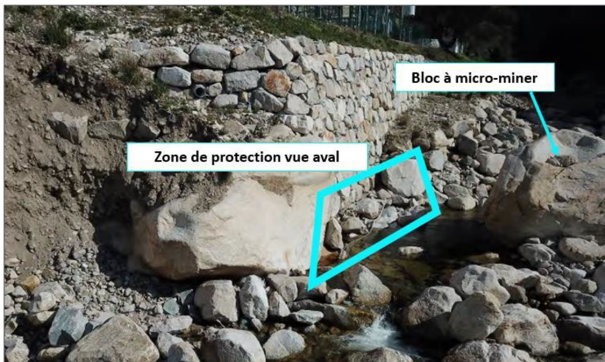
Figure 9: vue de l'enrochement dégradé lors de la crue de 2023
